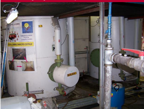
Izmjenjivači topline i kotlovi
